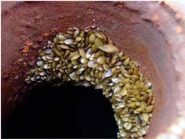
COLÔNIA DE MEXILHÃO DOURADO EM TUBULAÇÃO
