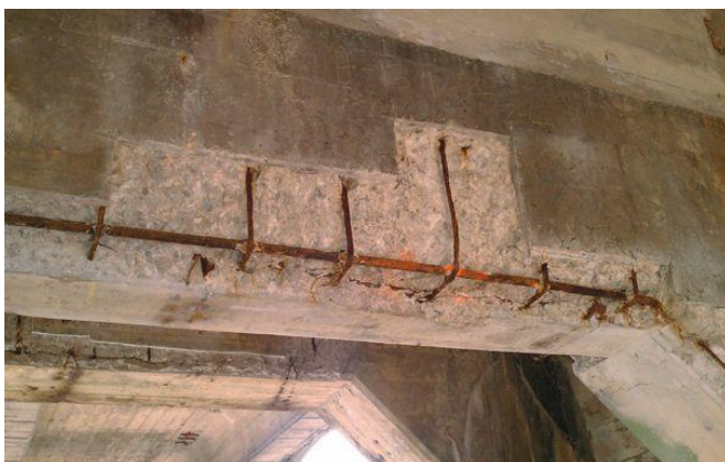
Ferrugem – oxidação é a transformação lenta de um metal em seus óxidos.
