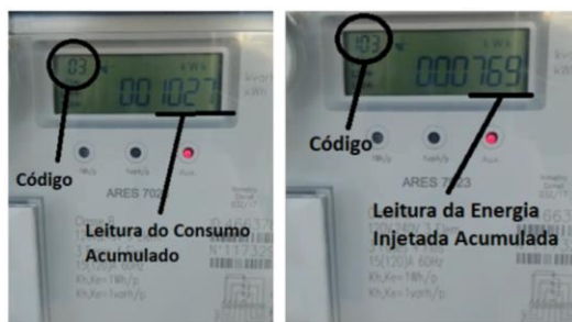
Figura 1 – Medidor trifásico de microgeração
