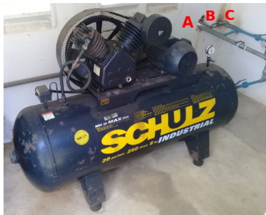
Figura 4.6: Compressor de Ar.
