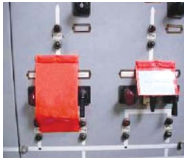
Figura 2 - Exemplo de sinalização de Bloqueio de Equipamento ou Circuito
