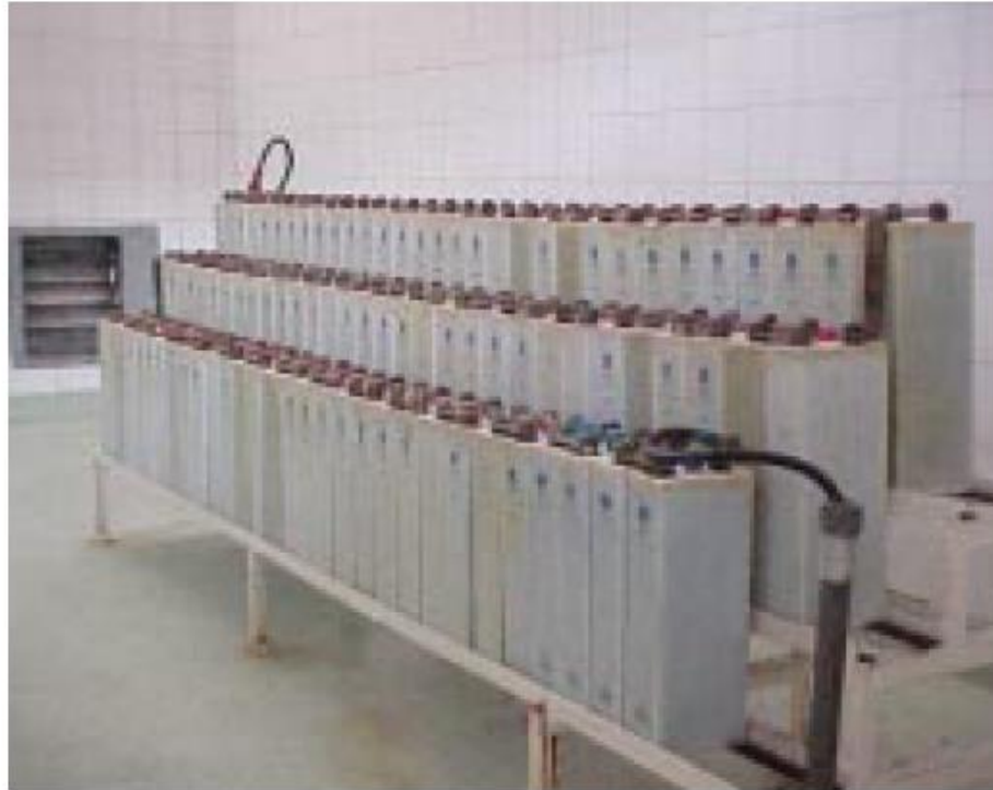
Banco de baterias
