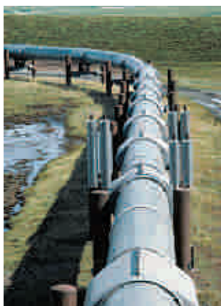
Trecho de um oleoduto.
