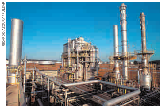
Torres de refino de petróleo da Petrobras, em Paulínia (SP).
