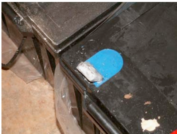
Figura 7.2: Uma bateria de chumbo-ácido de 200 Ah. O terminal negativo está quebrado por causa do peso em cima do mesmo durante o transporte.
