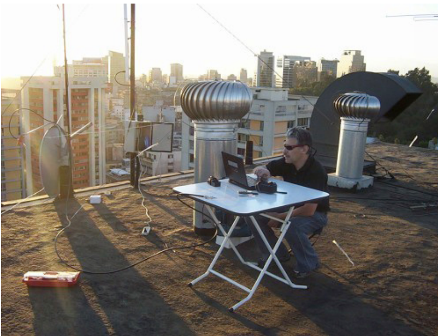
Figura 11.23: Nó central de Santiago, conectado ao nó no sul da cidade. Repare na antena parabólica para esta conexão e a antena omnidirecional encaixada para a conexão com os clientes.
