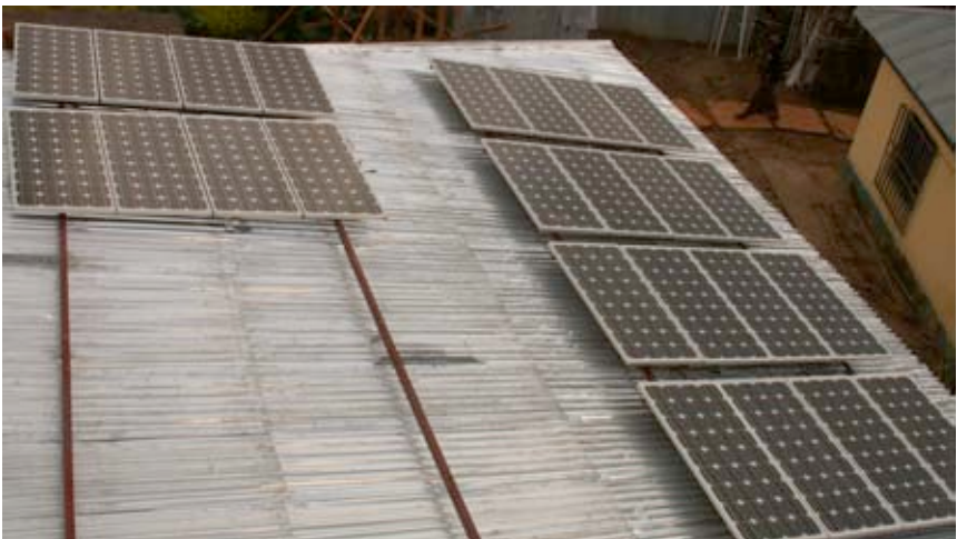
Figura 11.1: 24 painéis solares com a potência nominal de 80 W foram montados no telhado do centro de operações para garantir a alimentação ininterrupta ao sistema.
