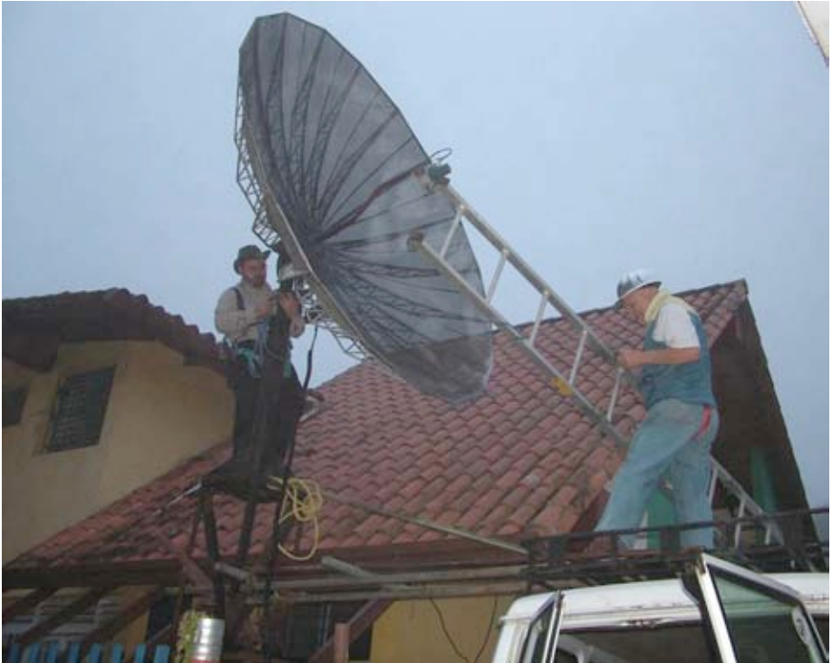
Figura 11.30: Carlo e Ermanno desmontando o prato de satélite fornecido pelo Sr. Ismael Santos.
