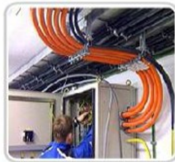
A separação dos cabos de dados dos de energia elétrica devem cumprir as normas de segurança.
