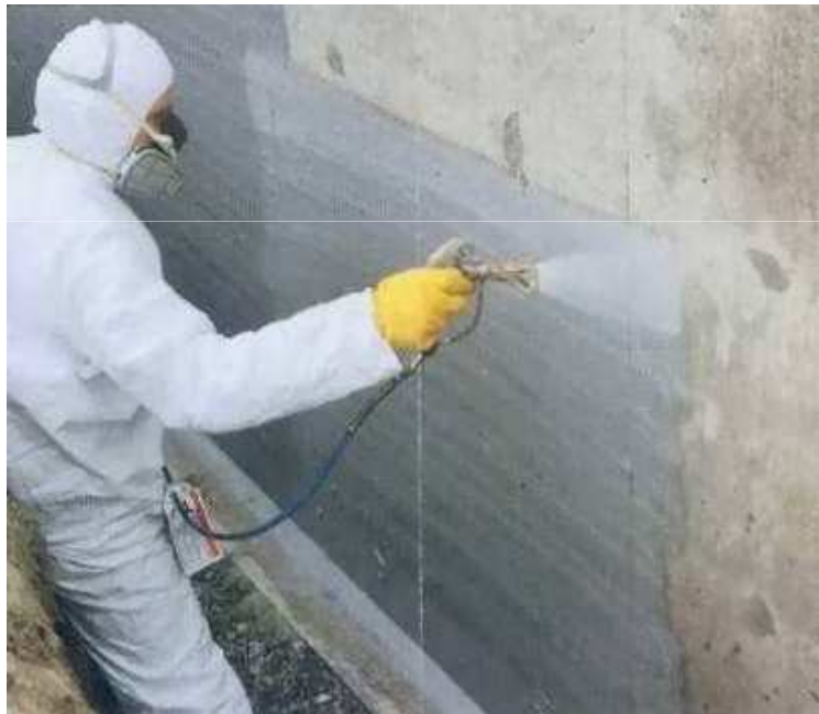
Selam os poros do concreto
