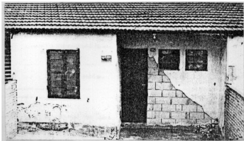
9.4 - Argamassa em processo de deslocamento por falta de chapisco.
