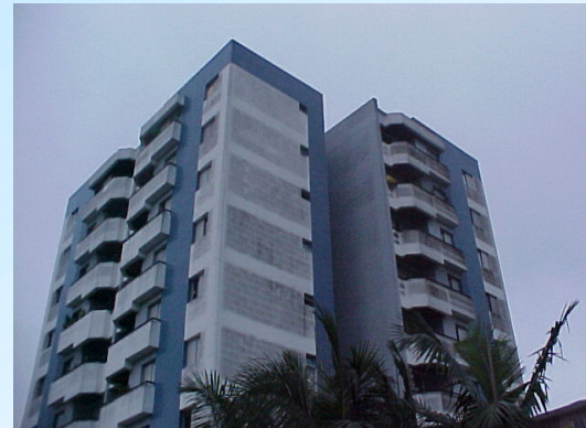
Manchas generalizada no exterior: presença de fungos na vedação de alvenaria de blocos de concreto celular
