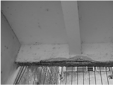
Corrosão das Armaduras devido a influência do cobrimento
