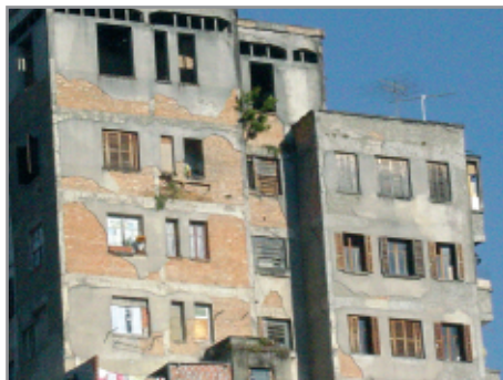
Foto 01 - Edifício com alto grau de degradação
