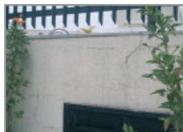
Foto 16 - Quadro de fissuração generalizada
